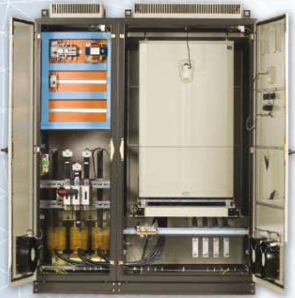
Acionamento com Inversores de Frequência
